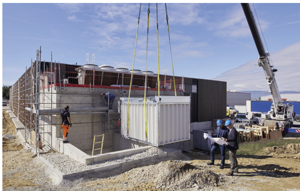
Installation de l'accumulateur de glace (conteneur gris)
