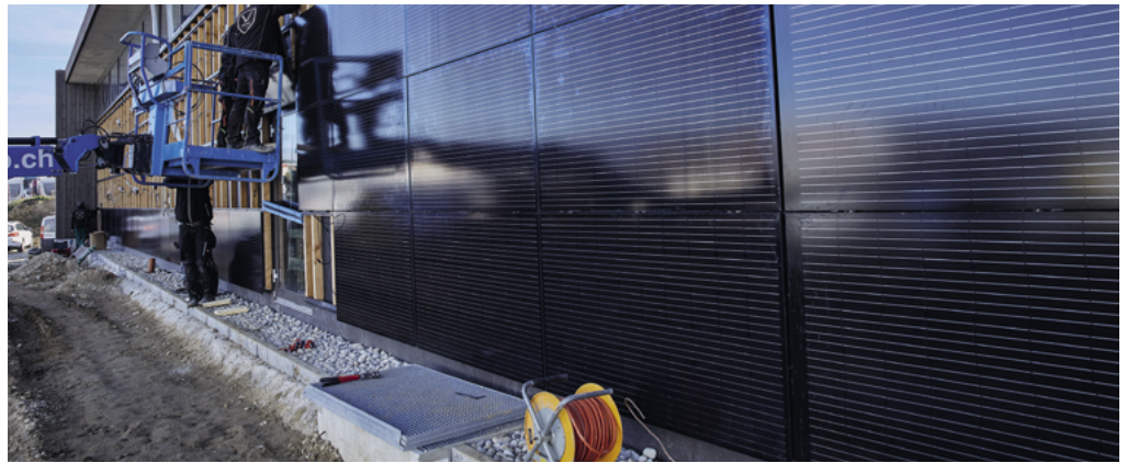
Installation photovoltaïque de la façade
